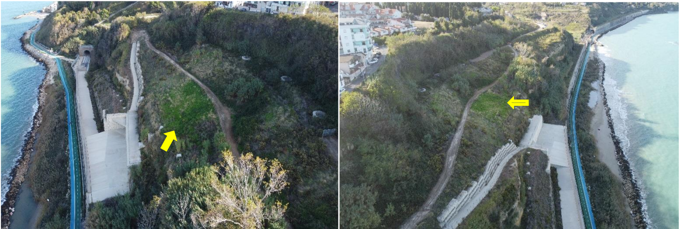
Figura 4. Il cantiere FS a Ortona: Si noti la zona più verdeggiante indicata dalle frecce gialle dove i Prati Armati® continuano a traspirare l'acqua in eccesso. Nella zona indicata era avvenuta una frana dovuta a infiltrazioni non regimate.
